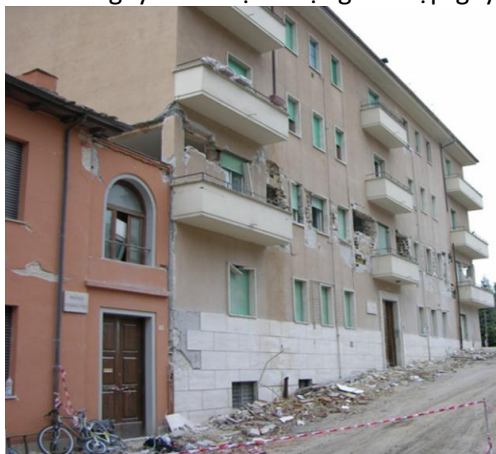
Hình 1. Đứt gãy kết cấu do vập – Trận động đất L'Aquila vào tháng 4/2009 tại Ý
